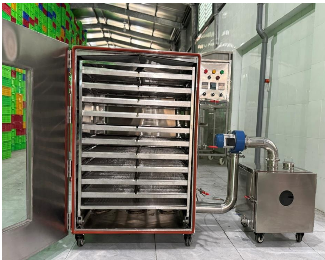
Hình 5.185. Hình ảnh phía trong thiết bị xông khói lắp đặt và chạy thử tại Công ty TNHH Thương mại Cá Việt
