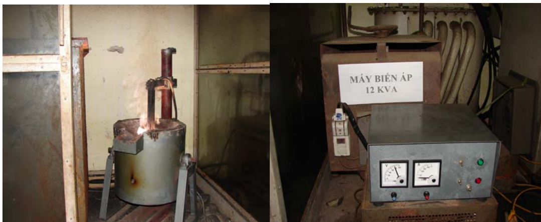
Hình 6: Lò điện hồ quang 12KVA
