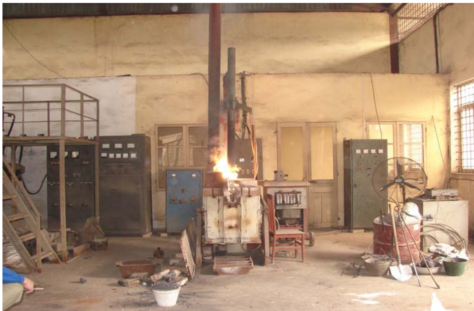
Hình 7: Lò điện hồ quang 100KVA
